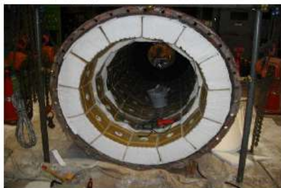
・「加熱炉排気ダクト(熱回収用)」
